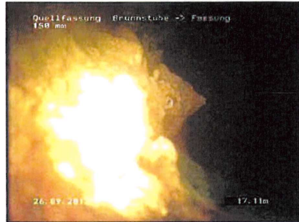
17.11 m Inkrustation an der Rohrverbindung 7 bis Foto 10 10 Uhr
