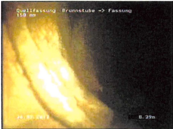
7.38 m Rohrmaterialwechsel: Steinzeug Foto 11 8.29m Rohrmuffen
