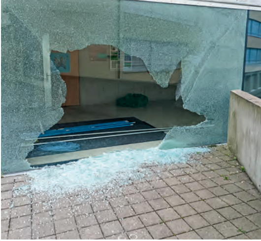
Beschädigte Glasscheibe im Schulhaus 03
