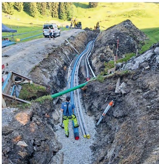
Leitungsgaben zwischen Quelle und Abgabeschacht Alpeli
