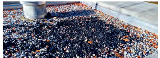
Auf dem Bild sind noch die Brandspuren zu sehen
