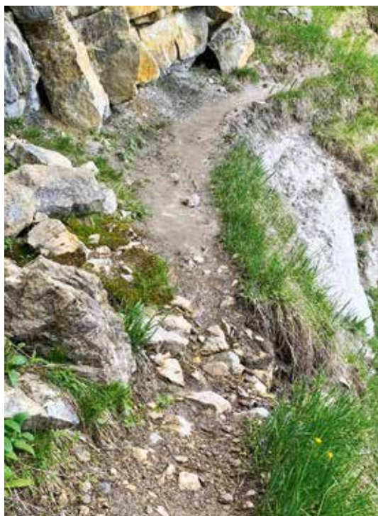
Wegschaden mit Absturzgefahr am «Rot Dossen» Alpnach
