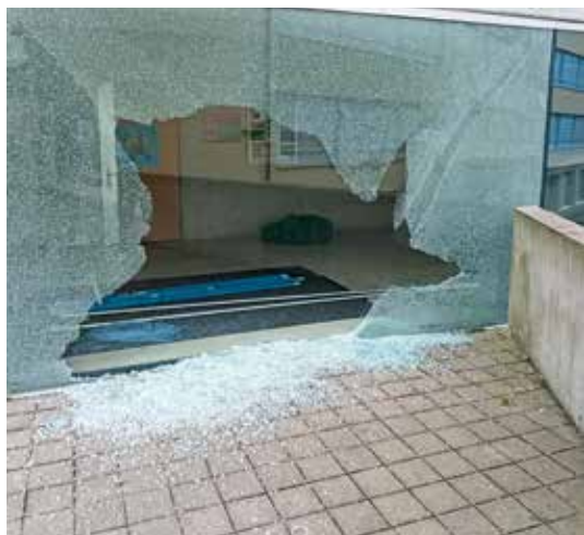
Beschädigte Glasscheibe im Schulhaus 03
