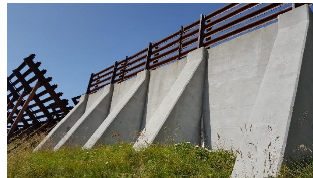
Verbauung am Matthorn
